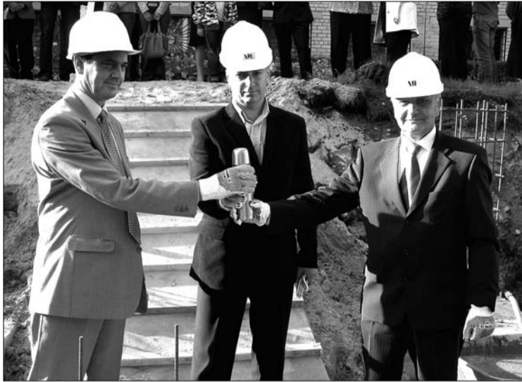
Pirms kapsulas ar vēstījumu nākamajām paaudzēm iemūrēšanas Olaines 1. vidusskolas piebūves pamatos. Kapsulu gatavoja iemūrēt Olaines 1. vidusskolas direktors J. Volāns (no kreisās), būvfirmas "NĪA" valdes loceklis I. Kreics un Olaines pilsētas domes priekšsēdētājs J. Pavlovičs.
